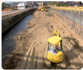
河川浚渫(しゅんせつ)実施箇所 (県管理干見折川 免地地区)
